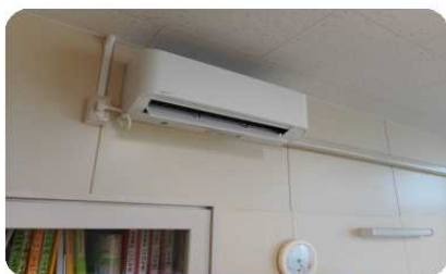
保健室のエアコン
